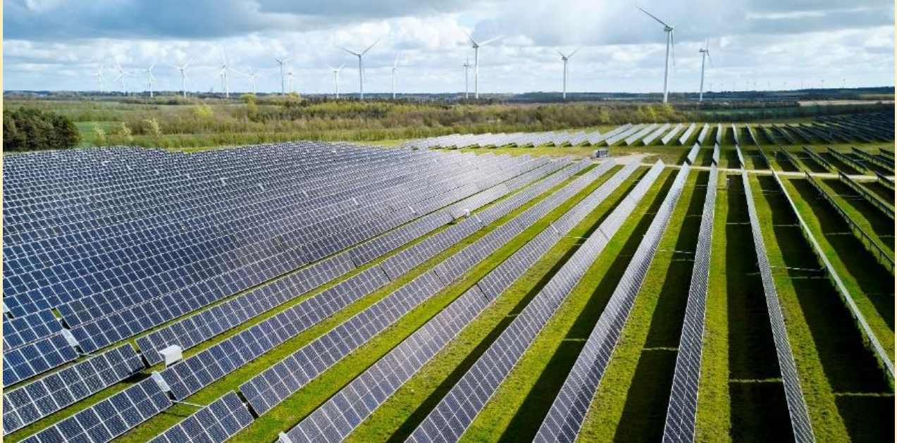
Figur 6: Foto fra eksisterende hybridanlæg.
